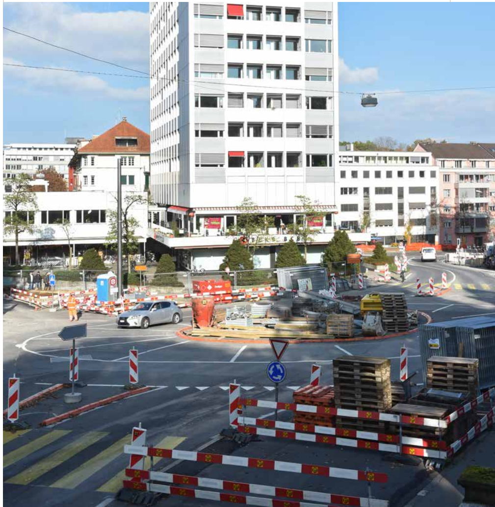
Eiger ohne Nordwand: Umbauarbeiten am Eigerplatz in Bern, im Vordergrund ein zeitgemässer Kreisell, hinten das klassische Hochhaus.
