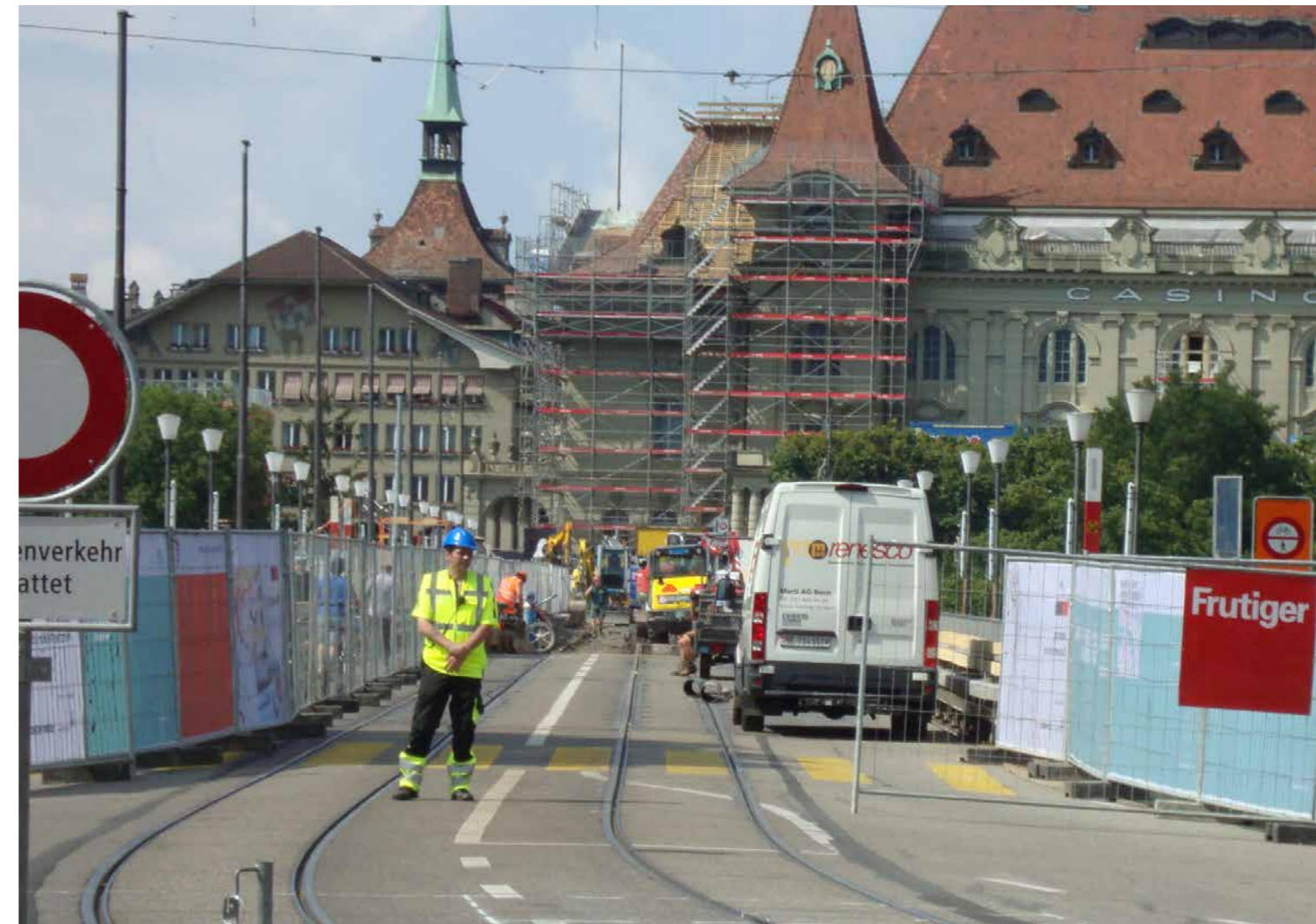
Gelungenes Beispiel dafür, wie richtige Baustellen-Signaletik heute geht: Erneuerung Kirchenfeldbrücke in Bern 2017
