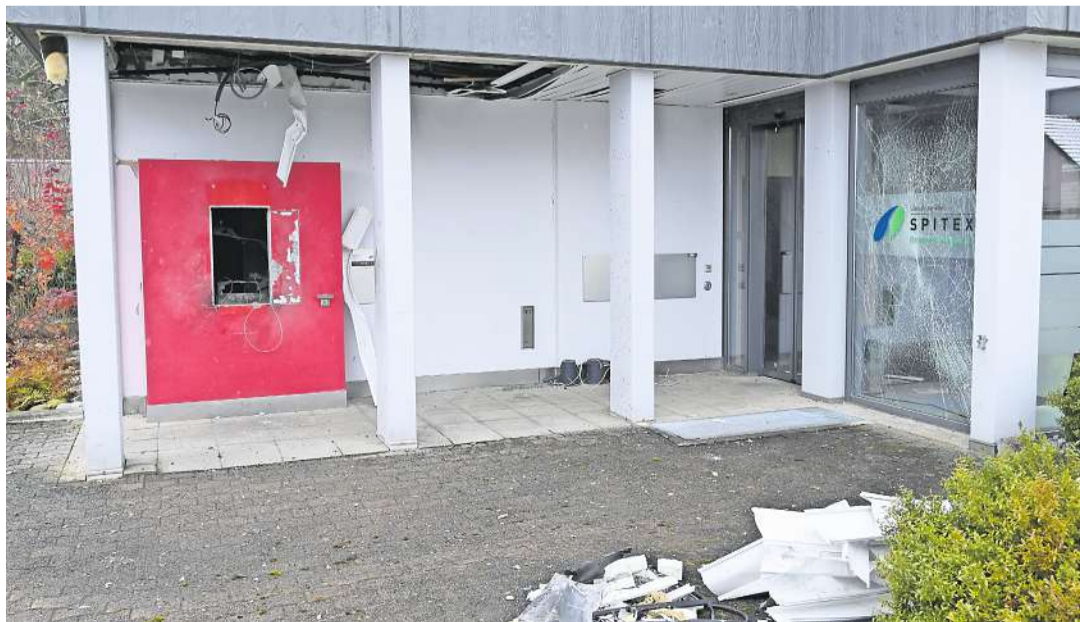
Die Wucht der Explosion hat die Dachkonstruktion sowie das Panzerglas beim Eingang zur Spitex beschädigt.
